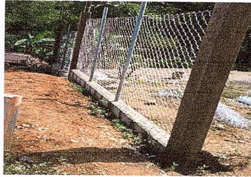
Foto 4: SUSTICION DE MALLA Y BASES
